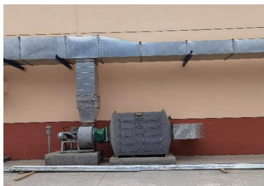
2#活性炭吸附处理设施
