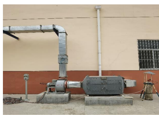
4#活性炭吸附处理设施
