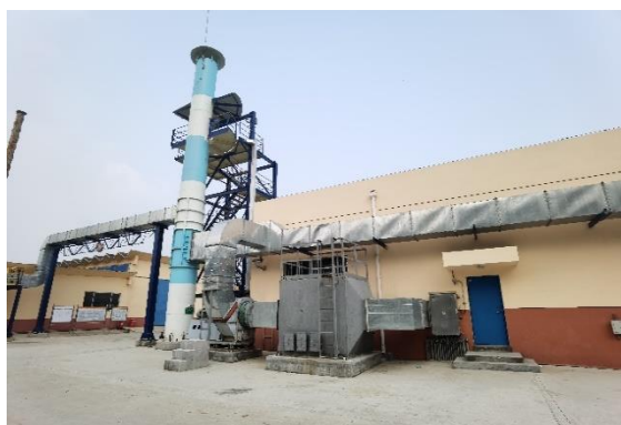
废气处理设施
