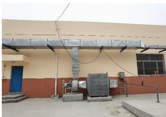
3#活性炭吸附处理设施
