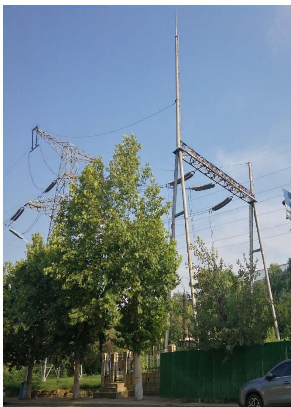
图 4-1 220kV 烯化线终端站
