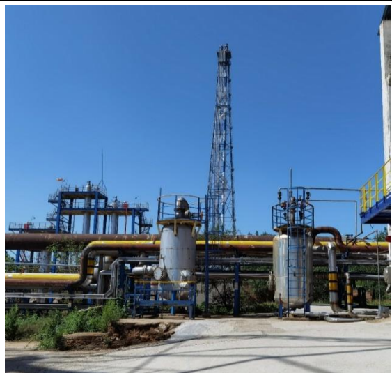
老凝缩油回收罐
