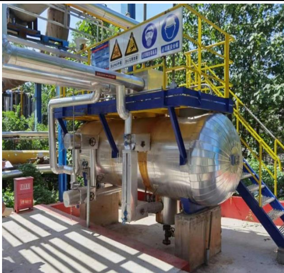
新凝缩油回收罐
