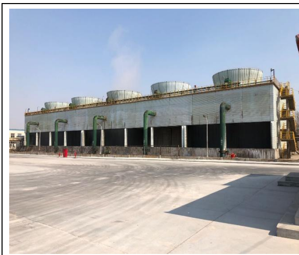
循环水冷却塔
