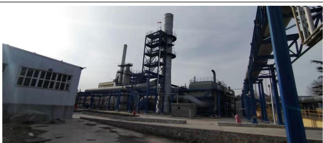
顺丁橡胶、丁苯橡胶废气处理设施及废气排气筒
