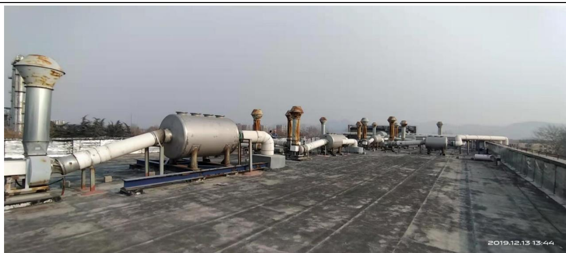
RTC 综合楼废气排气筒
