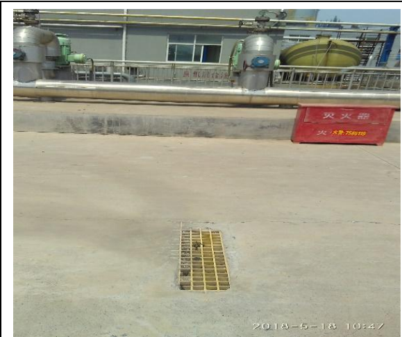
图 12-2 地面硬化及雨排
