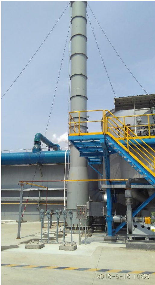
图 11-3 第一污水处理场废气处理装置
