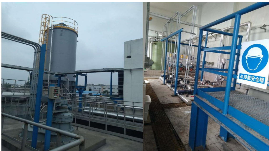
微砂活性炭吸附装置加药系统
