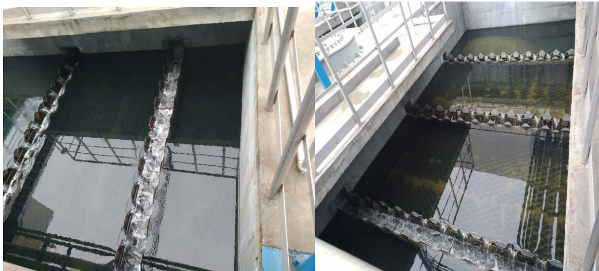
低盐水接触池 高盐水接触池
