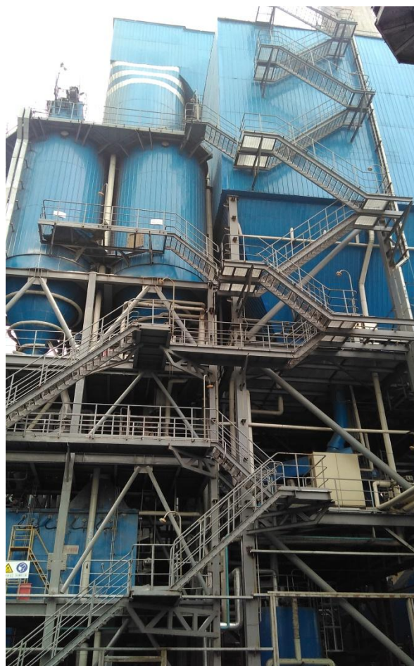
2#炉脱硫、脱销系统（南）
