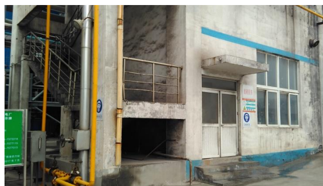
脱销系统（泵房）
