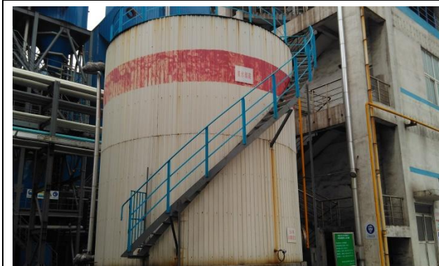
脱销系统（氨水罐）
