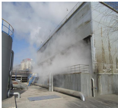
循环冷却水系统（冷却塔）
