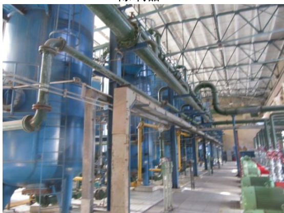
除盐水处理站（离子交换器）
